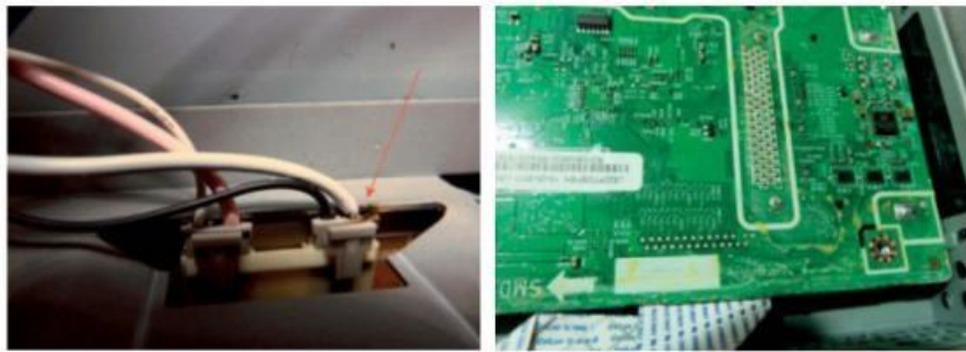
Figure 2. Présence d'un arc électrique
